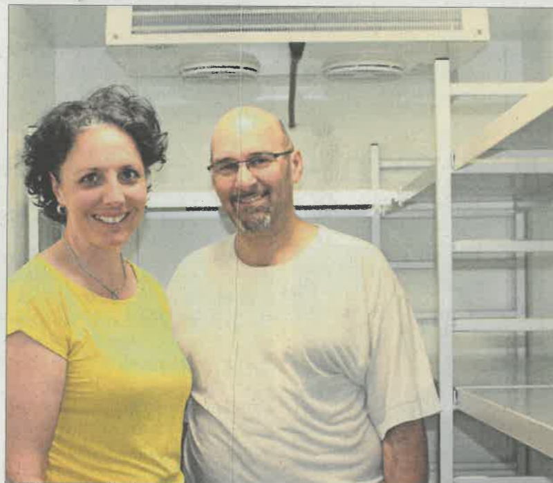
Barbara und Michael Wahlich vor ihrer neu eingebauten Kühlanlage. Dort können viel mehr Teiglinge als sonst reifen. Durch die spezielle Lagerung bei 3 bis 4 Grad Celsius und hoher Luftfeuchtigkeit werden die enzymatischen Vorgänge verbessert, womit Brot und Gebäck besonders gut verträglich werden. – Foto: Karin Kleinert
